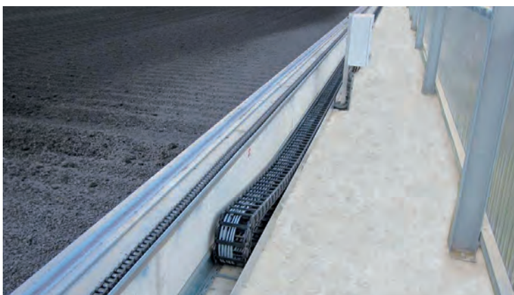
▲ Chaîne porte câbles, côté couloir de maintenance.
