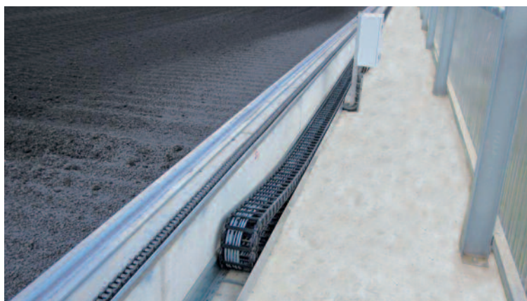
▶ Cadena portacables, del lado del pasillo de mantenimiento.
